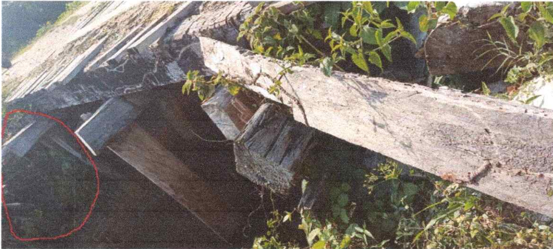
Falta da Contenção
