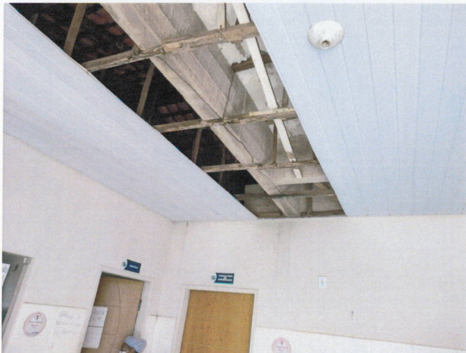
Foto 02: Reg. fotográfico da situação-Engenharia e Fiscalização/SEMUST
