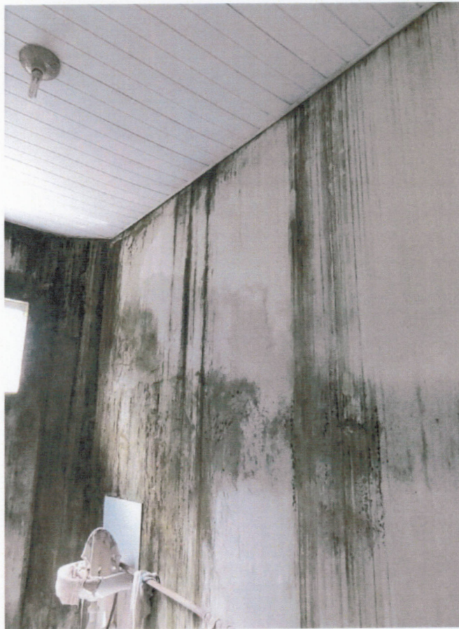
Foto 03: Reg. fotográfico da situação-Engenharia e Fiscalização/SEMUST
