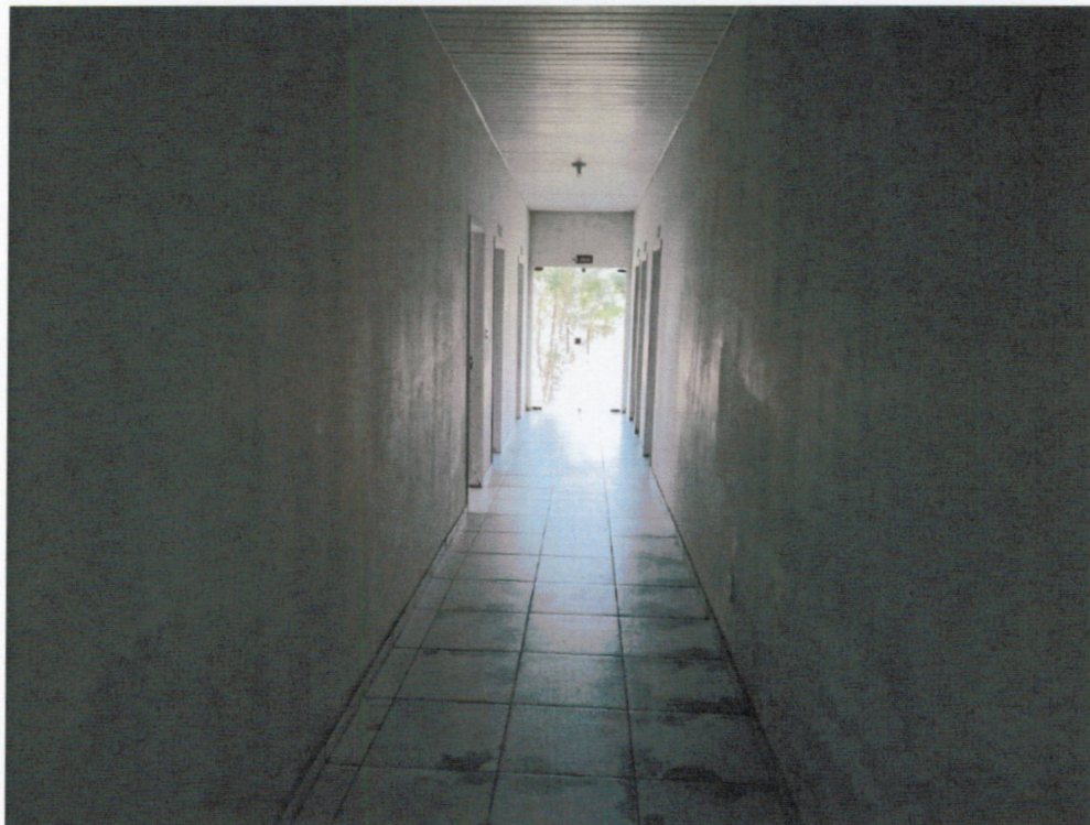
Foto 07: Reg. fotográfico da situação-Engenharia e Fiscalização/SEMUST
