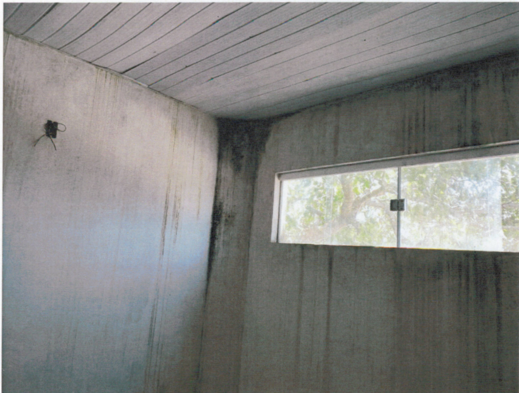
Foto 10: Reg. fotográfico da situação-Engenharia e Fiscalização/SEMUST
