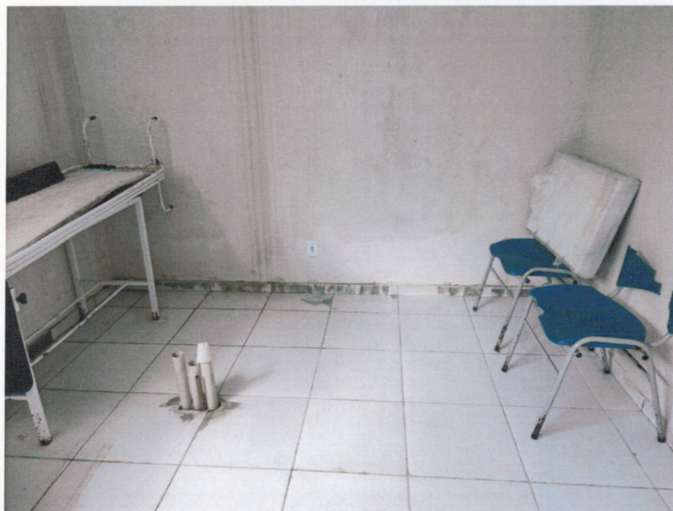
Foto 08: Reg. fotográfico da situação-Engenharia e Fiscalização/SEMUST
