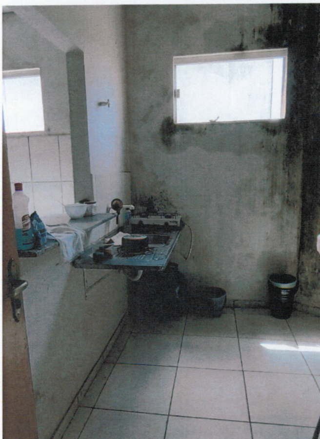
Foto 04: Reg. fotográfico da situação-Engenharia e Fiscalização/SEMUST
