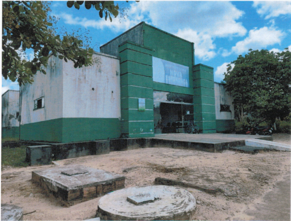
Foto 01: Reg. fotográfico da situação-Engenharia e Fiscalização/SEMUST
