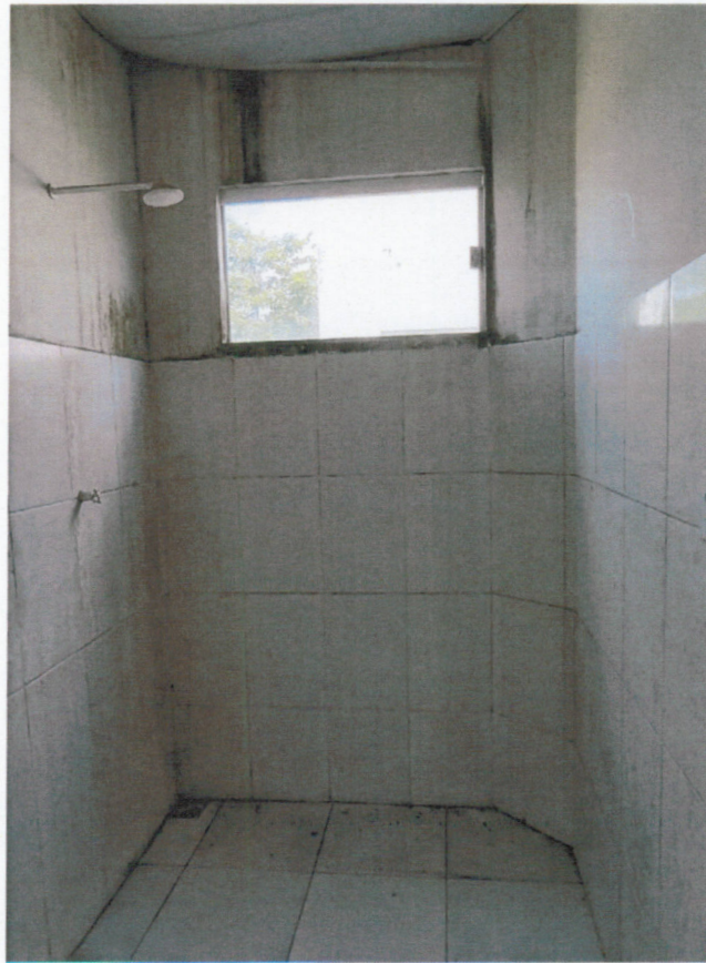
Foto 09: Reg. fotográfico da situação-Engenharia e Fiscalização/SEMUST
