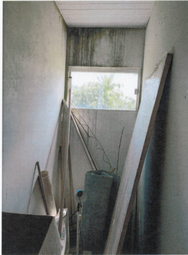
Foto 05: Reg. fotográfico da situação-Engenharia e Fiscalização/SEMUST
