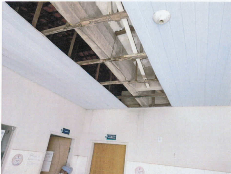
Foto 02: Reg. fotográfico da situação-Engenharia e Fiscalização/SEMUST
