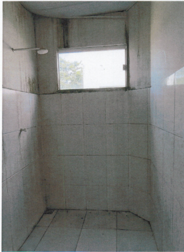
Foto 09: Reg. fotográfico da situação-Engenharia e Fiscalização/SEMUST
