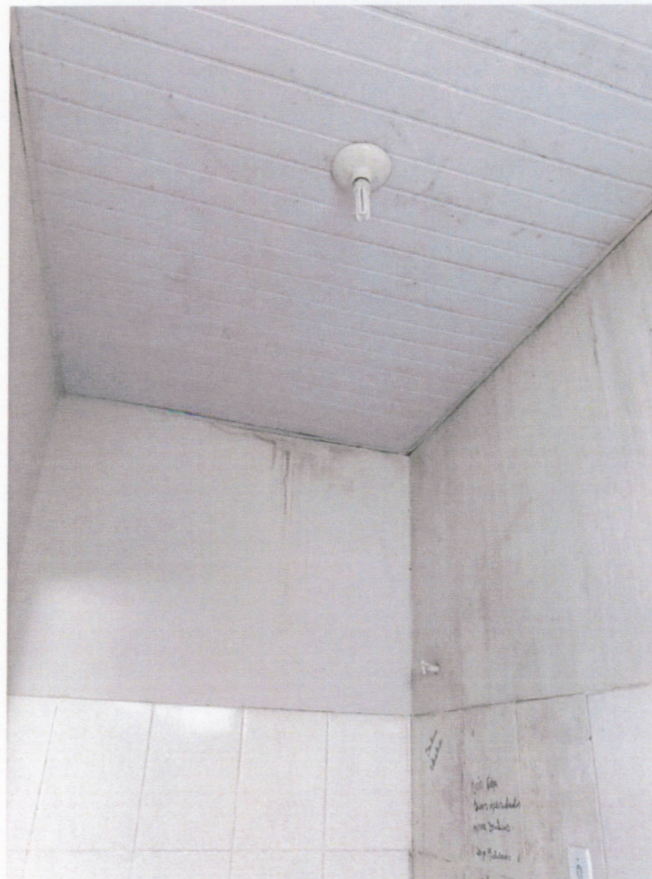
Foto 06: Reg. fotográfico da situação-Engenharia e Fiscalização/SEMUST
