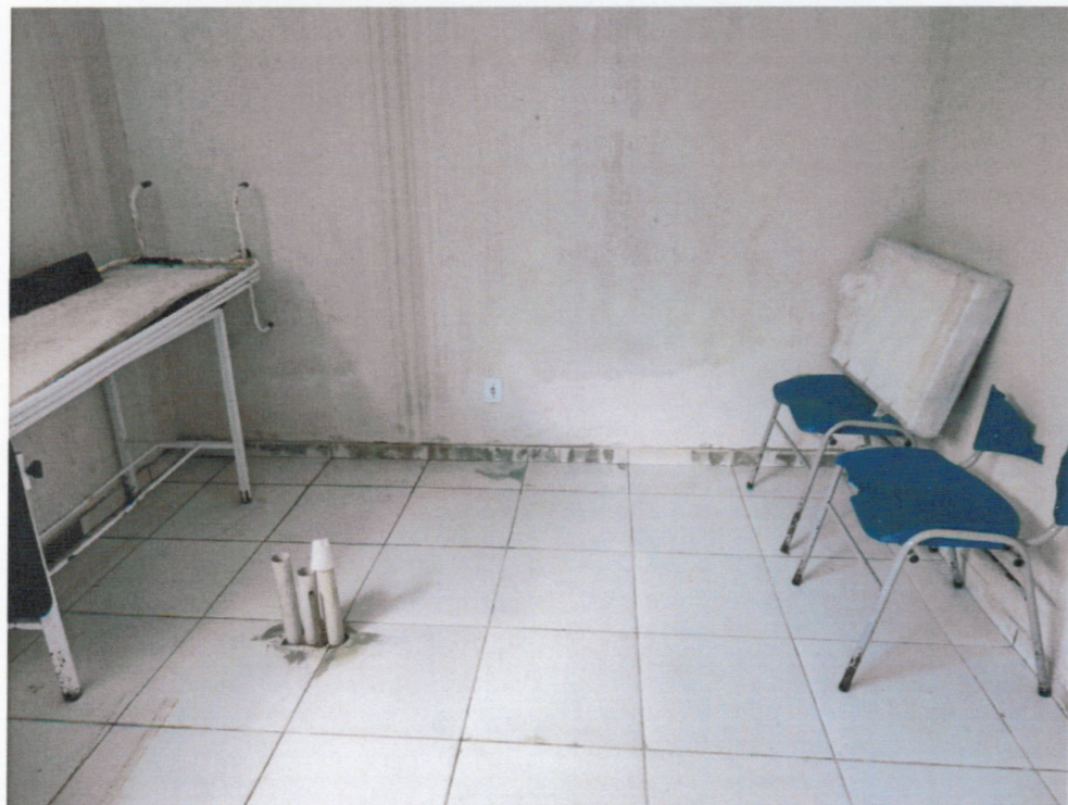
Foto 08: Reg. fotográfico da situação-Engenharia e Fiscalização/SEMUST
