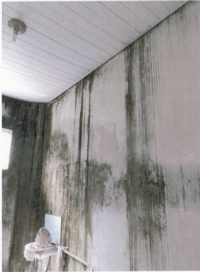
Foto 03: Reg. fotográfico da situação-Engenharia e Fiscalização/SEMUST
