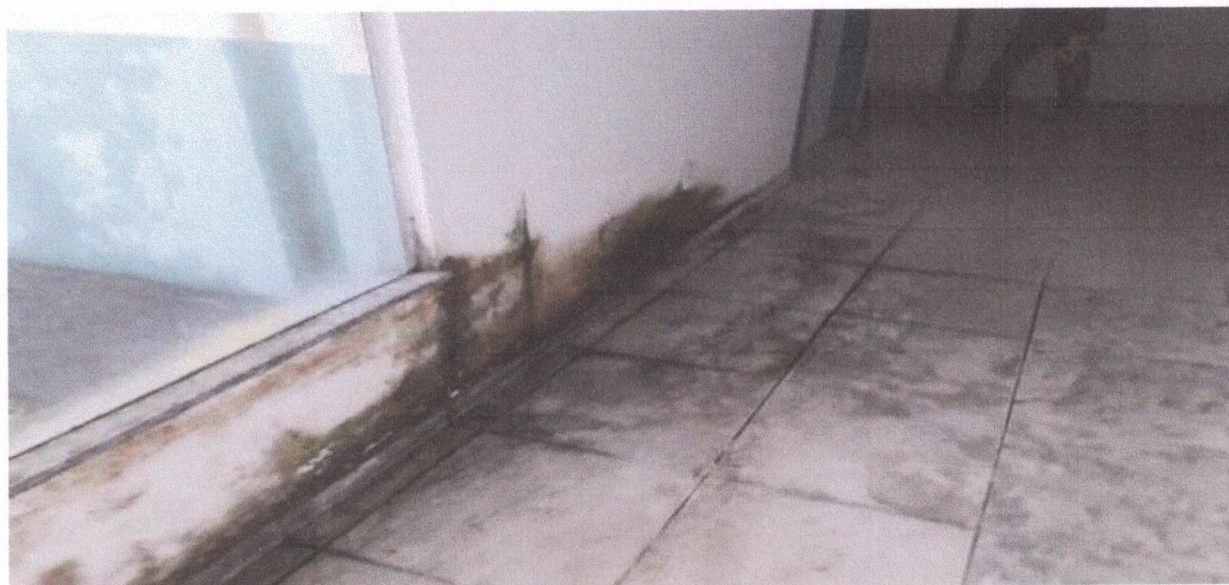
Reg. fotográfico da situação-Engenharia e Fiscalização/SEMUST
