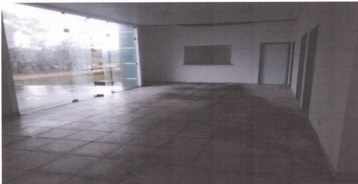
Reg. fotográfico da situação-Engenharia e Fiscalização/SEMUST
