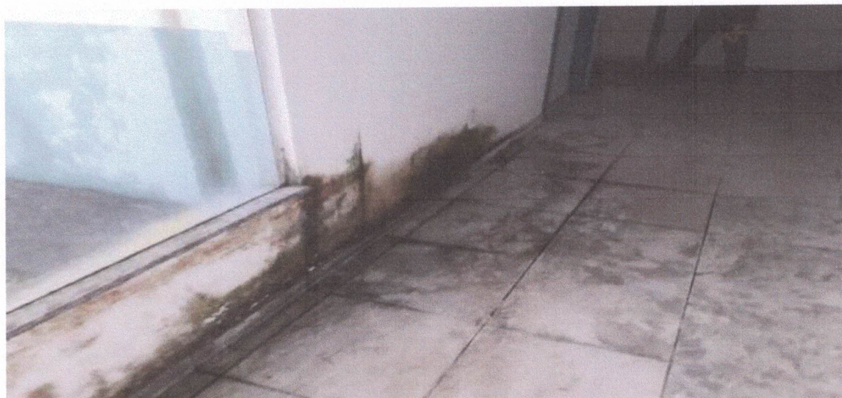
Reg. fotográfico da situação-Engenharia e Fiscalização/SEMUST
