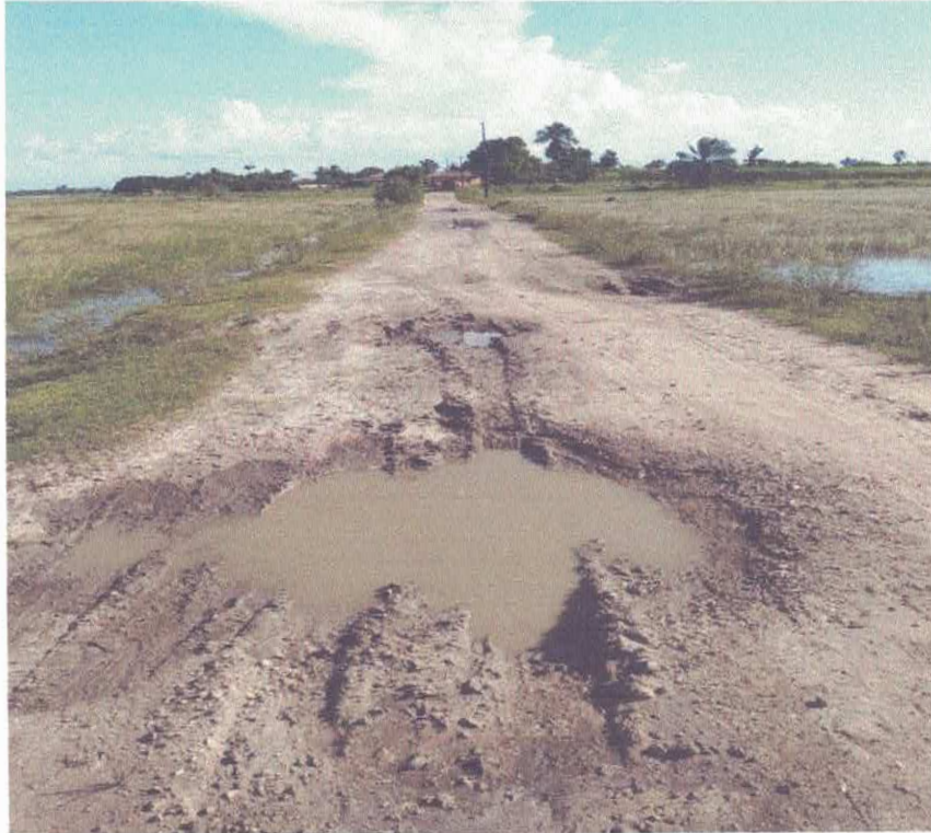
FOTO 06: Estrada na comunidade da Ilha Serrada. Aterro com trecho danificado.
