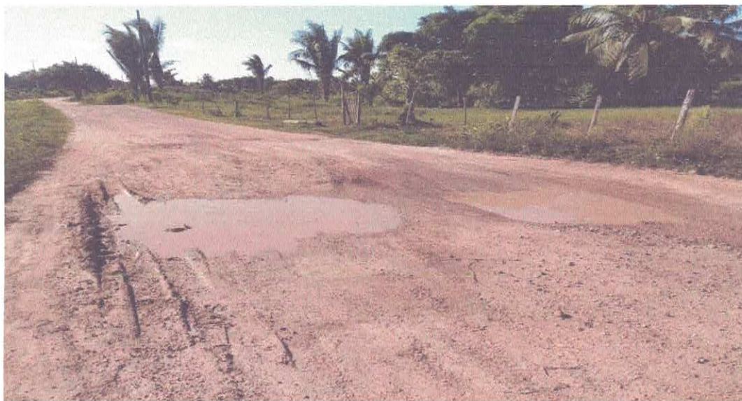
FOTO 09: Trecho danificado da estrada, próximo à comunidade Vila Boa Vista.
