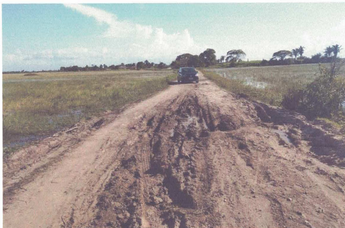
FOTO 05: Estrada na comunidade da Ilha Serrada. Aterro com trecho interditado
