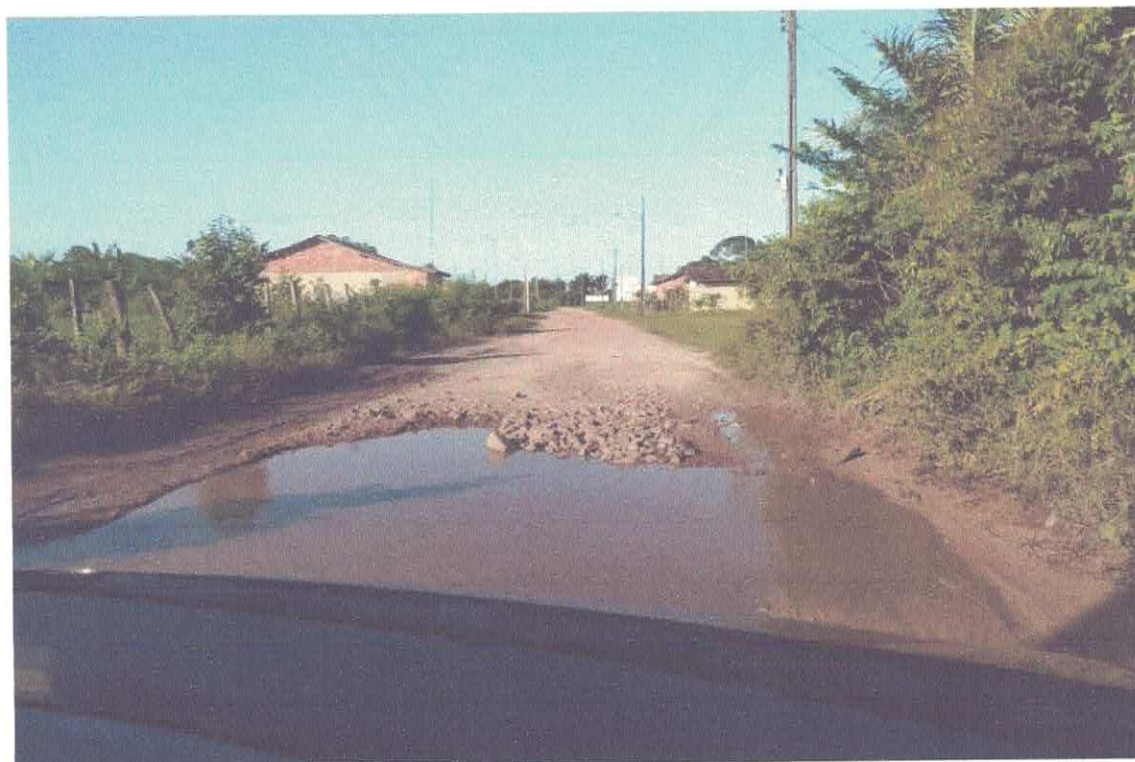
FOTO 13: Estrada na comunidade do Nanã. Água da chuva empoçada.
