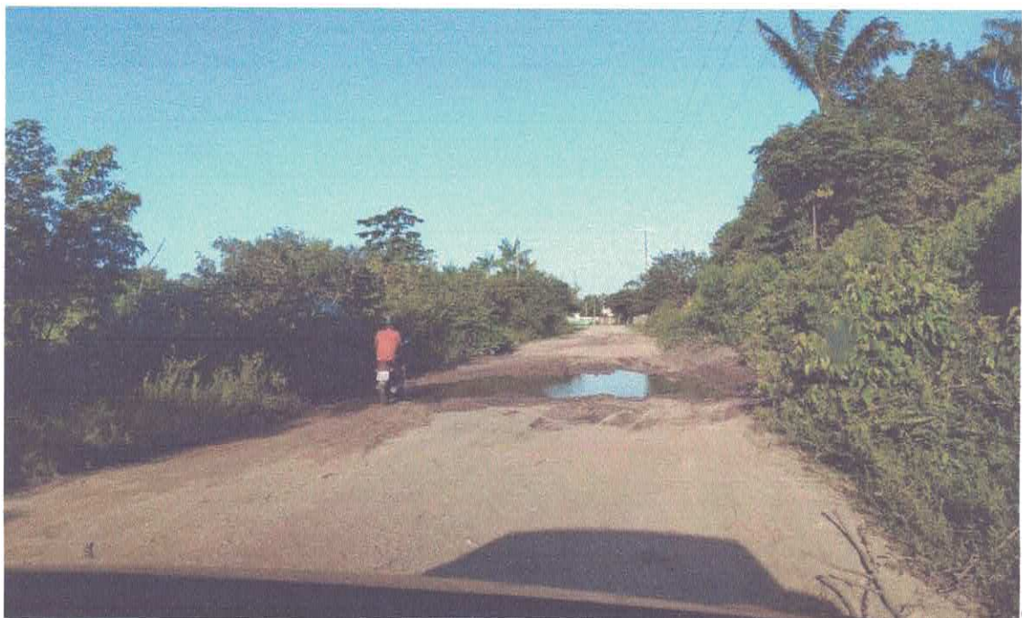
FOTO 17: Trecho da estrada próximo à comunidade da Flexeira. Água da chuva empoçada.
