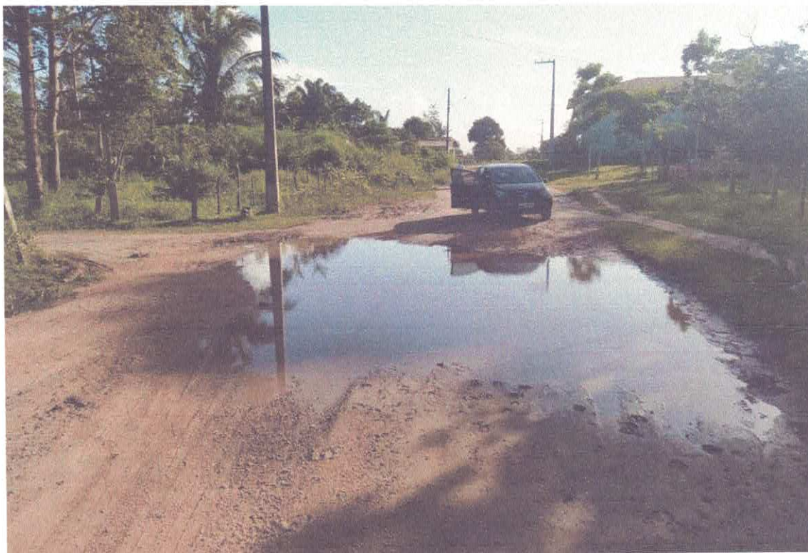
FOTO 12: Estrada na comunidade do Nanã. Água da chuva empoçada.
