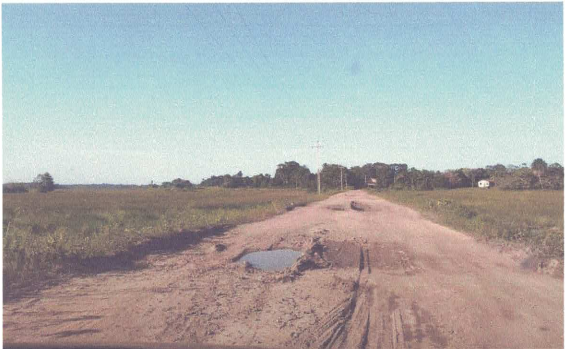
FOTO 11: Estrada na comunidade da Chapada. Trecho danificado.
