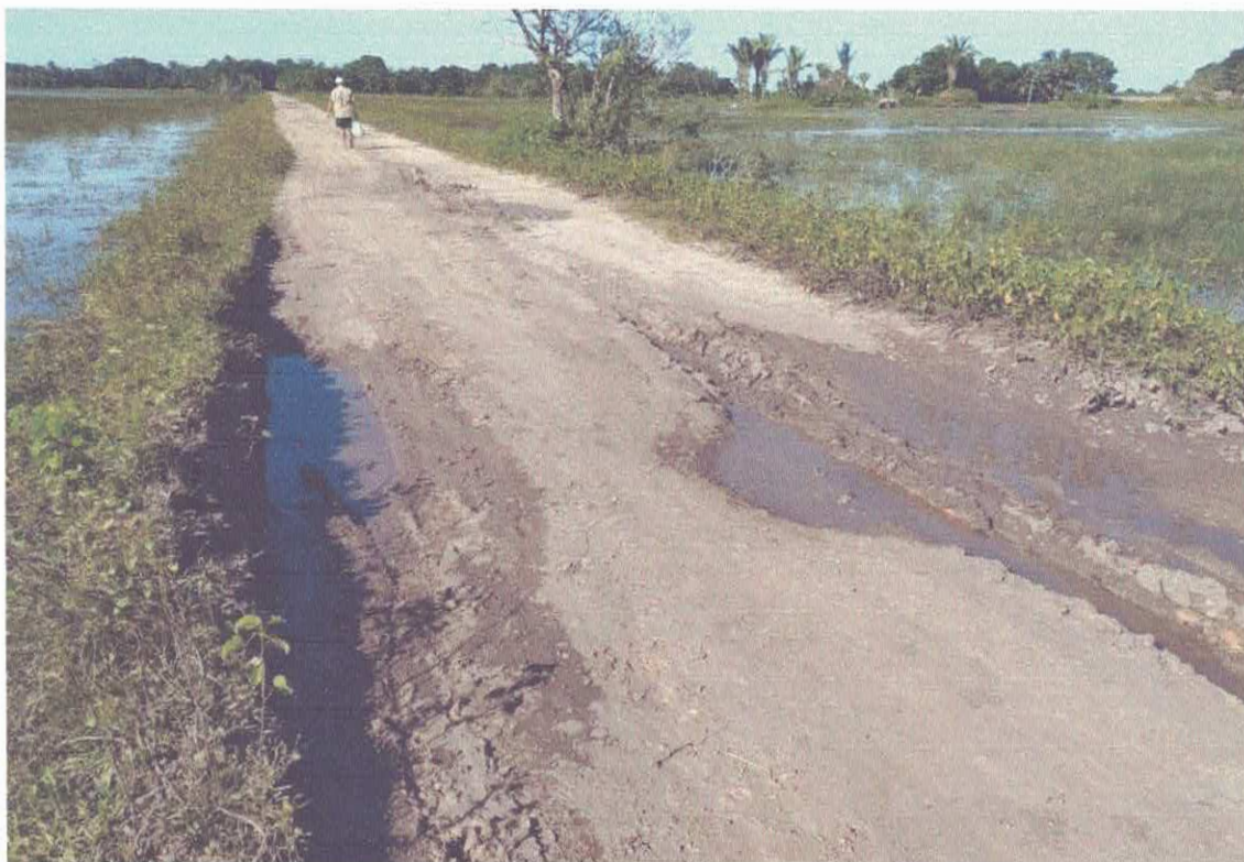
FOTO 04: Estrada na comunidade da Ilha Serrada. Aterro com trechos danificados.
