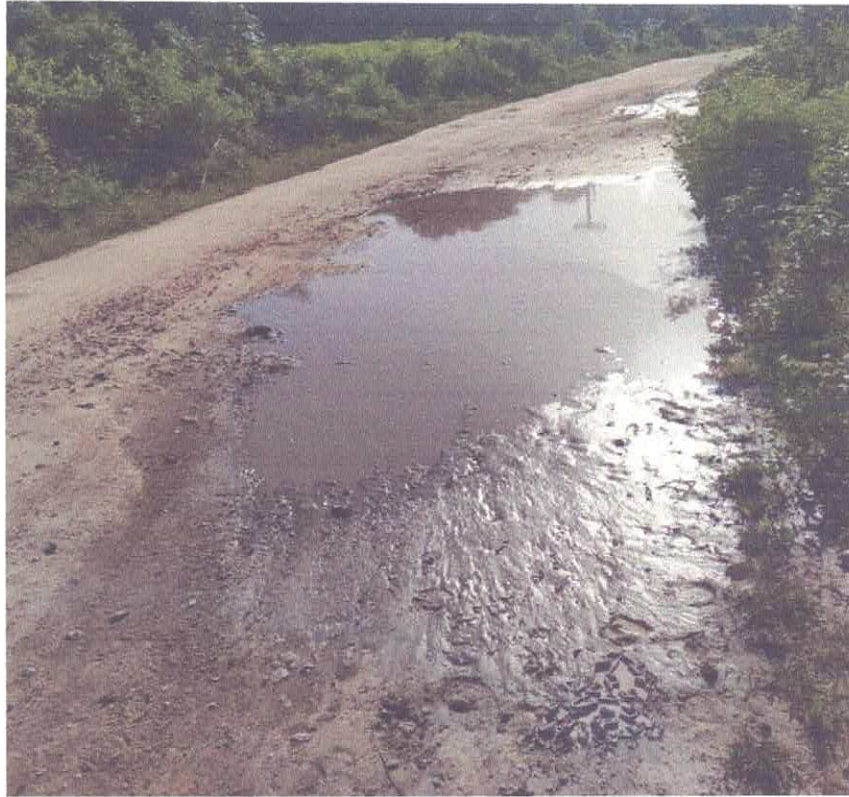
FOTO 10: Estrada próximo à localidade da Chapada. Água da chuva empoçada.
