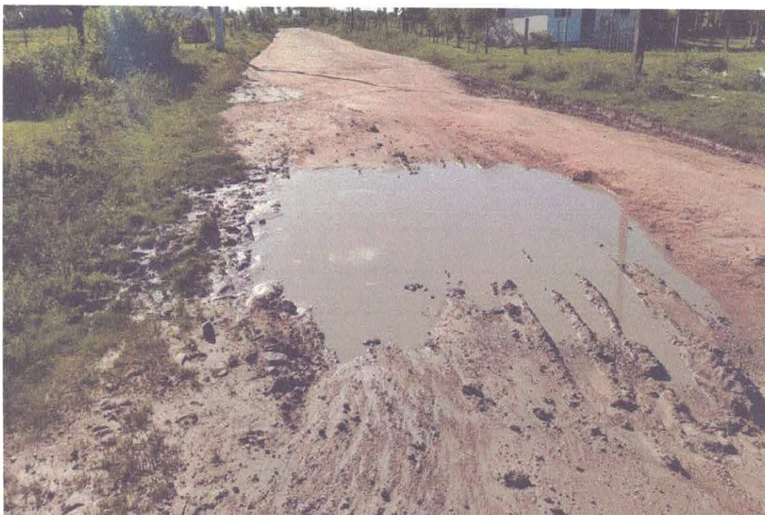
FOTO 08: Trecho danificado da estrada, próximo à comunidade Vila Boa Vista.
