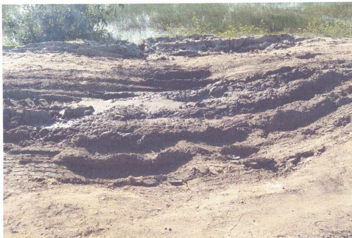
FOTO 03: Estrada na comunidade da Ilha Serrada. Marcas do tráfego em trecho comprometido.
