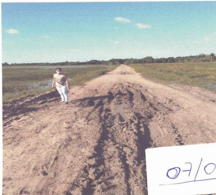
FOTO 07: Estrada na comunidade da Ilha Serrada. Marcas de tráfego, no trecho comprometido.
