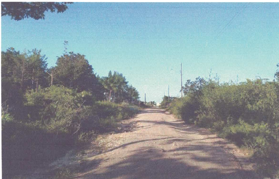
FOTO 14: Estrada na comunidade do Nanã. Trecho danificado pelas chuvas.
